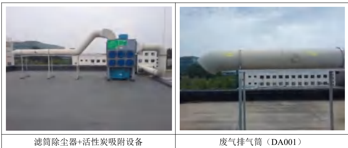
图 4.1-1 废气处理装置及排气筒
