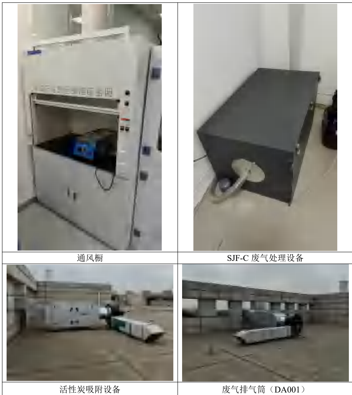
图 4.1-1 废气处理装置及排气筒
