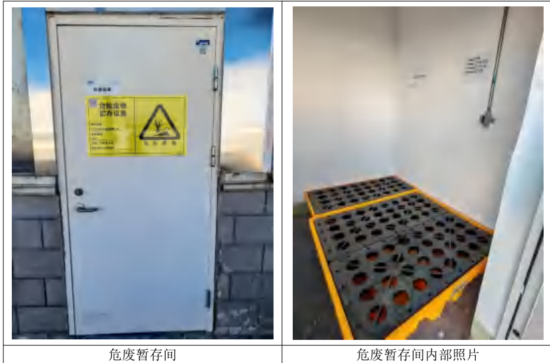
图 4.1-5 危废暂存间及危险废物暂存情况
